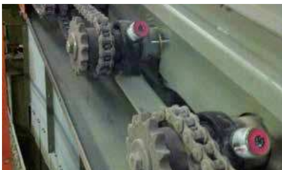
◆ リサイクルプラントチェーンコンベヤー
