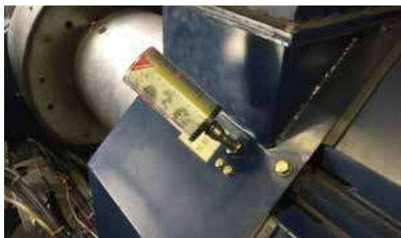
◆ 風力発電 発電機
